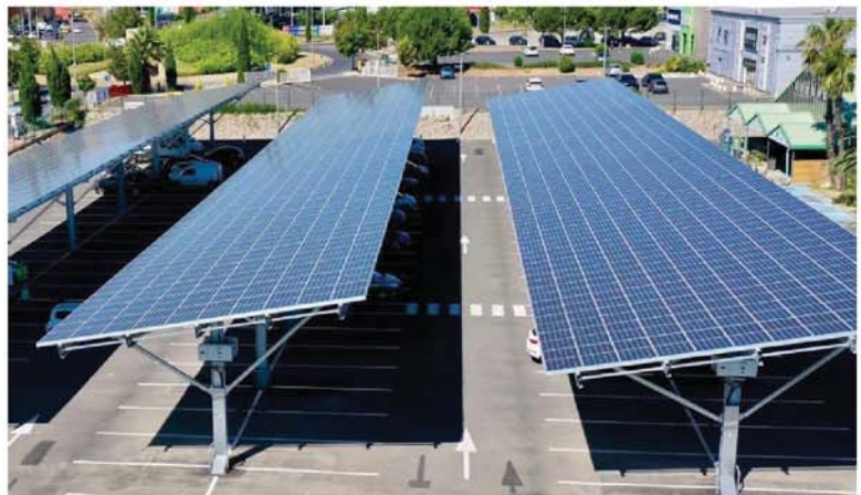
Figur 35: Eksempel på solceller som parkeringssskygge fra et anlegg i Beziers i Frankrike. Kilde: Sun'R'Power
