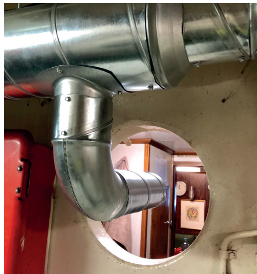
Uheldig skottgjennomføring (vann- og brann barrierer er brutt)
