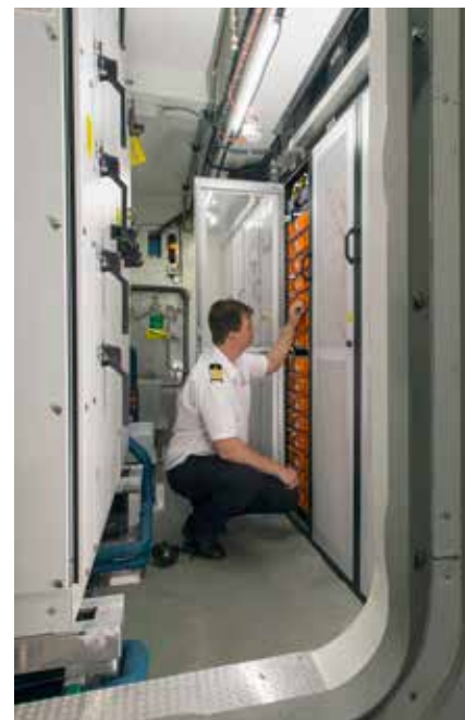
BATTERIROMMET: Her viser maskinsjef David Westgård Jansson fram batterirommet, som har en batteripakke på 600 kWh.
