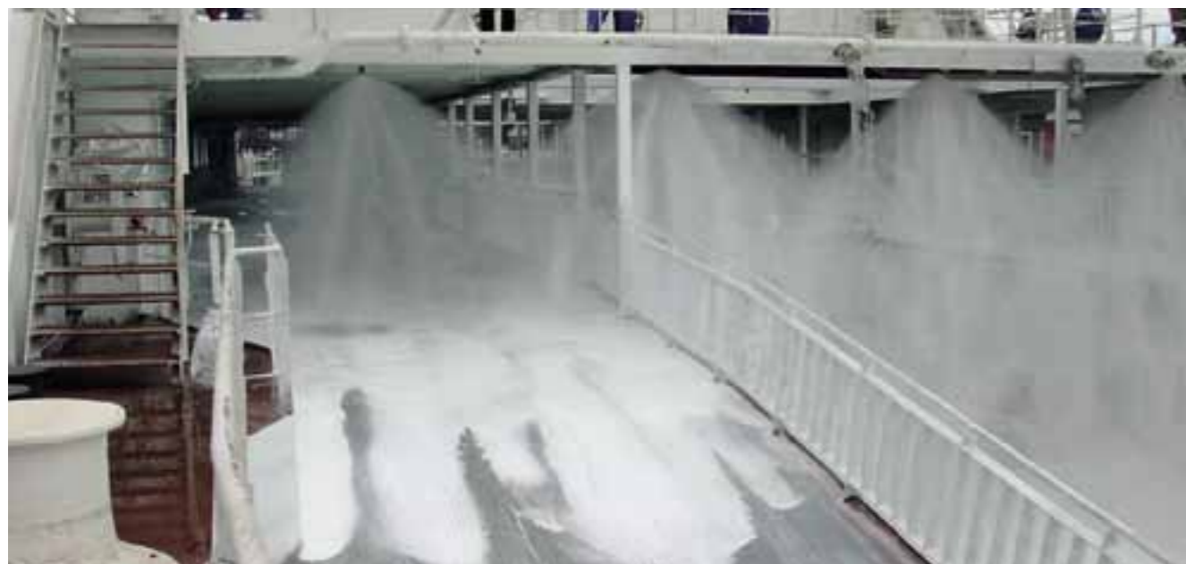
SKUMSLUKNING UNDER UTPRØVING. En skumslukningsgardin stopper effektivt spredning av brann.
